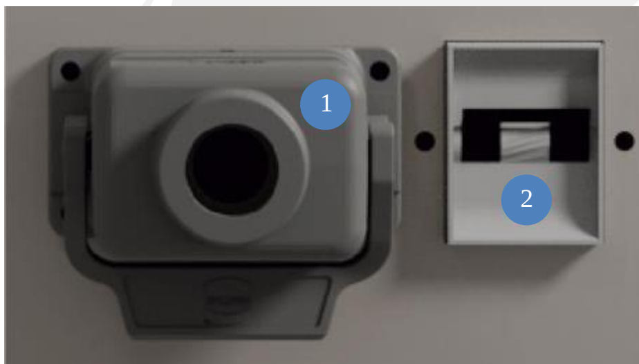
Figura 5 – Ligação transformador de solda.
